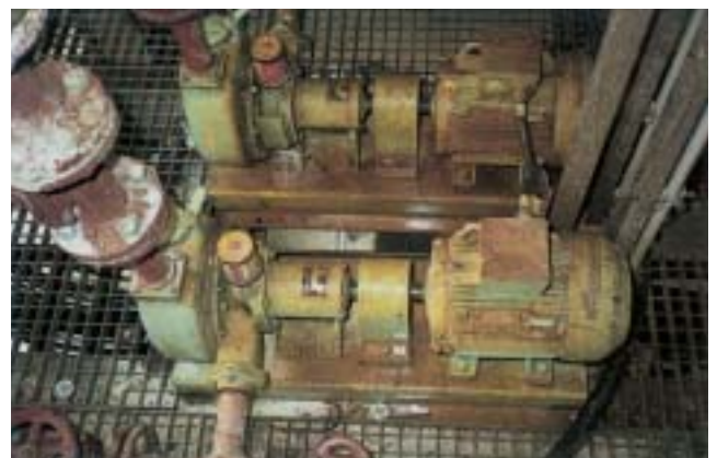
Pumpen J30-180 für die Dosierung von Neutralisierungslösungen
