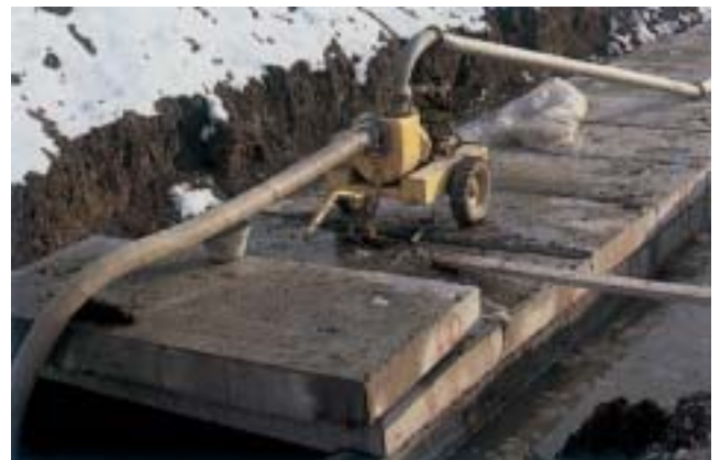
Pumpe J156-5, verwendet als Bypass für Abwässer
